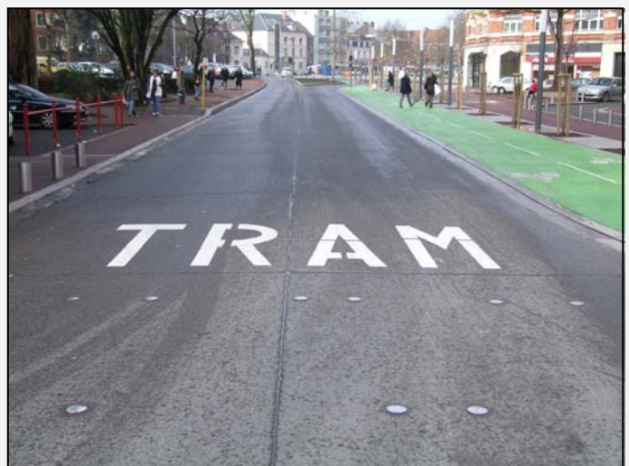
La plateforme en béton qui constitue le site propre du futur « tram » de Douai n'est pas continue : chaque jointure entre les plaques sera donc ressentie par les voyageurs. © ACTP
