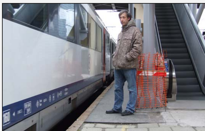
Voie 4 : à hauteur de l'escalator et du pilier en béton abritant l'ascenseur, la largeur du quai est insuffisante pour garantir la sécurité des voyageurs © ACTP
